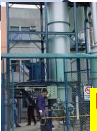
Bubbling bed gasifier
